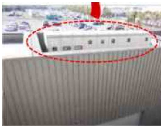
非常用発電設備を庁舎屋上に設置 (太子町)
