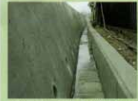
ドレーンの排水及び堤防表面からの表流水を集水します。
