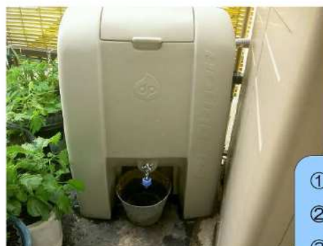
雨水貯留タンク設置の促進（伊丹市）
