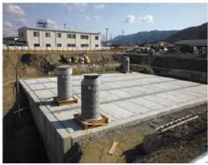
雨水貯留槽 (826m 3 )
