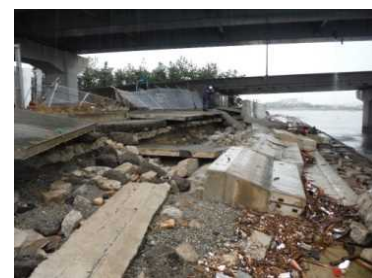
【被災状況（甲子園浜東護岸（I））】
