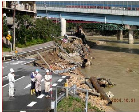
図 2-2 平成 16 年台風 23 号の被災写真（生瀬大橋上流右岸側）
