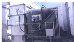
特別高圧変圧器
