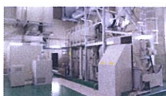
自家用発電設備
