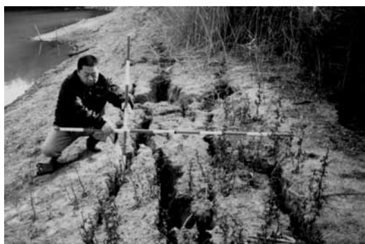
写真1 口無池(明石市)前法面亀裂 1)
