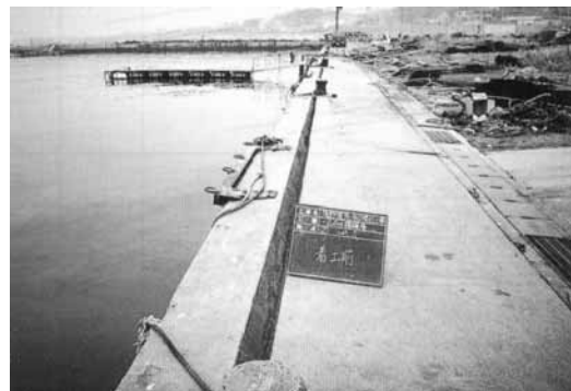
写真 17 浅野漁港 物揚場の被災状況 2)
