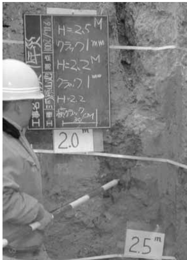
写真5 河原山池（稲美町）メチ レンブルー拡散の状況 1)
