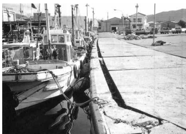
写真15 育波漁港 岸壁の被災状況 2)
