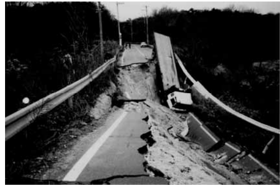
写真 13 奥池（三木市）堤体滑落 崩壊による堤頂道路被災 1)
