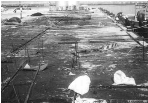
写真 16 育波漁港 物揚場の被災状況 2)
