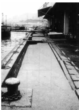
写真14 富島漁港 岸壁の被災状況 2)
