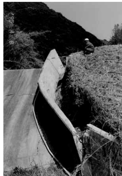
写真4 棕本池（津名郡北淡町） 洪水吐と堤体の剥離
