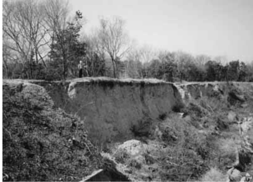
写真 12 大堤防池（神戸市西区） 前法滑落
