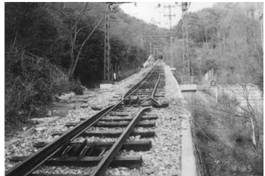
写真 19 六甲ケーブル軌道破断 4)
