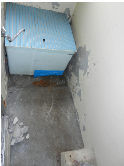
姫路御国野住宅現状写真 内部：狭い浴槽と老朽化した浴室
