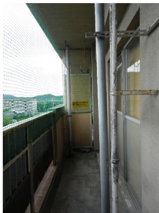
姫路御国野住宅現状写真 手狭で防災上不安全なバルコニー
