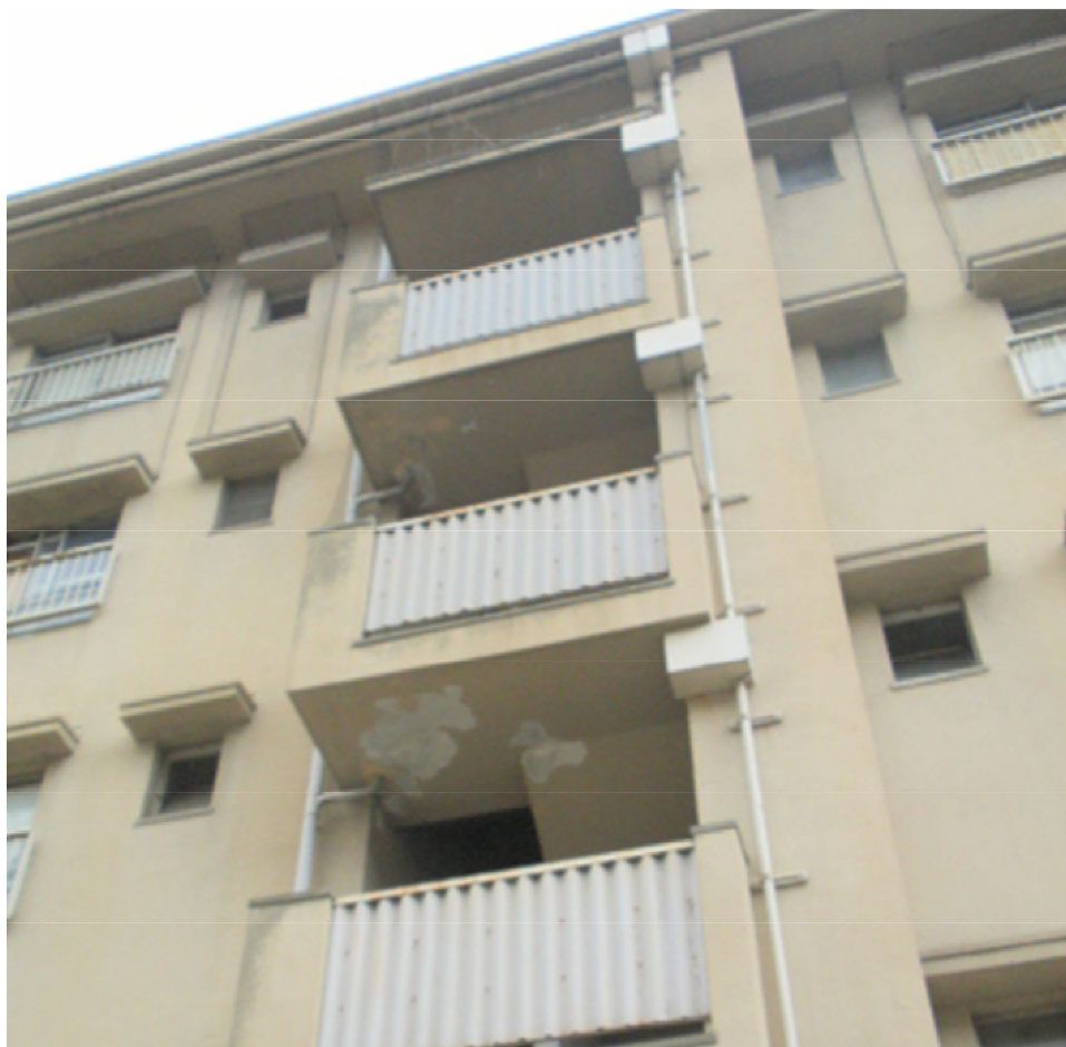
姫路御国野住宅現状写真 外部：階段室部分のコンクリート劣化状況
