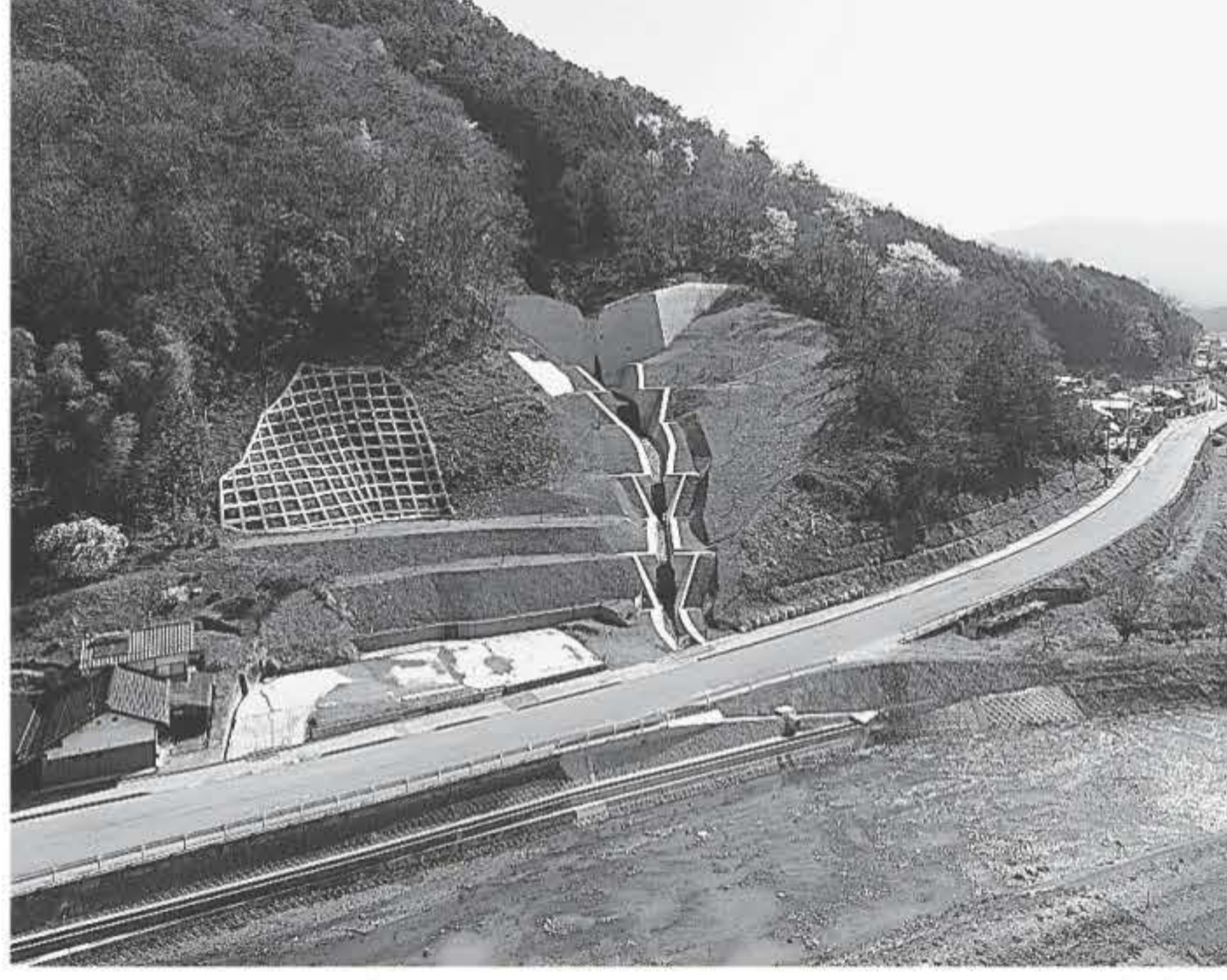
砂防えん堤が完成した徳尾東谷川の現場＝丹波市市島町徳尾
