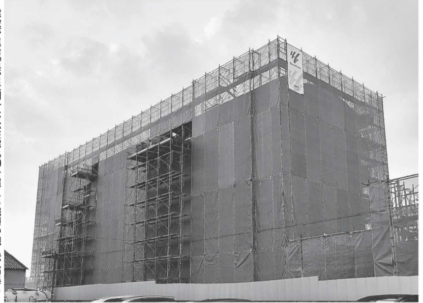
建設が進む県営豊岡一本松住宅。20を超える職種職人が結集し完成に向け力を合わせている。豊岡市庄境字中原
