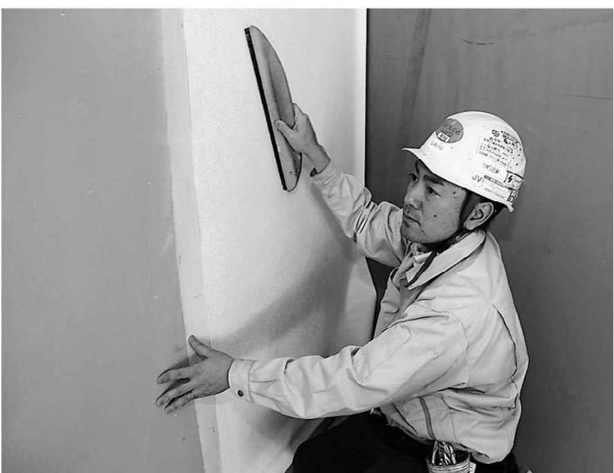
壁面にクロスを張り、刷毛でしわを伸ばす塩入裕介さん。人の目につきやすい部分だけに、丁寧な仕事が求められる
