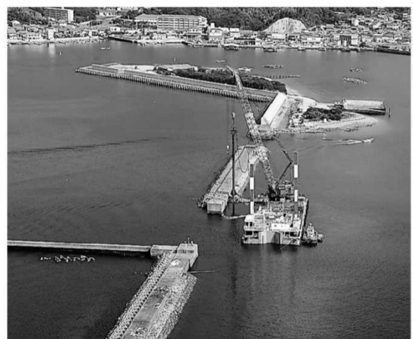
防波堤の補強のための鋼管を打ち込むくわい打込み機(起重機)が、垂直に海底に打ち込むには高い技術力が必要とされる。
