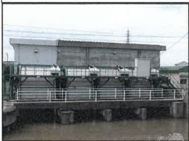
孫太川排水機場(S62ポンプ増設)
