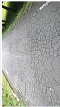
（舗装のひび割れ状況）
