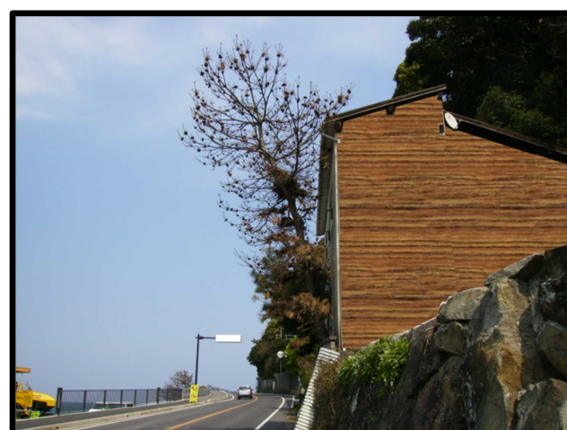
【道路脇で樹木が枯れているケース】
