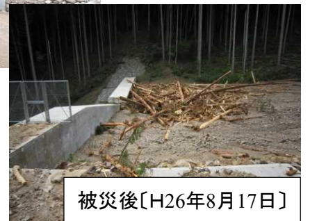
土石流を捕捉 (市島町)
