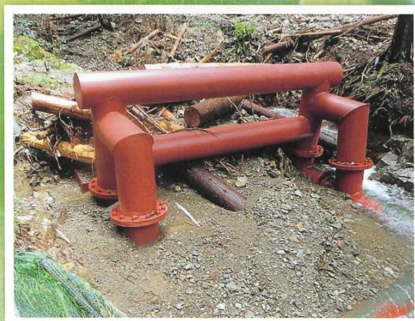
災害に強い森づくり (簡易流木止め施設による流木の防止)
