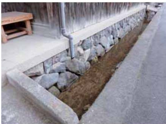
用水溝の蓋がけは最小限とし、できるだけ水の流が見えるようにする
