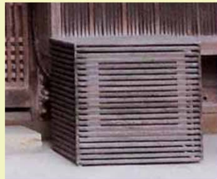
室外機を木製の枠により目隠した例
