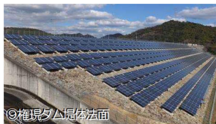
ダム堤体設置の太陽電池モジュール
