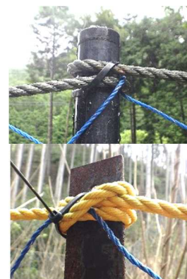
図 43 ずさんな施工(上)と正しい施工の例
