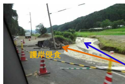
護岸侵食による路側崩落状況 (丹波市市島町上鴨坂)
