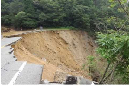
道路の崩落状況 (神戸市北区有馬町)
