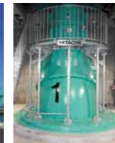
排水ポンプ(口径 2,200mm)
