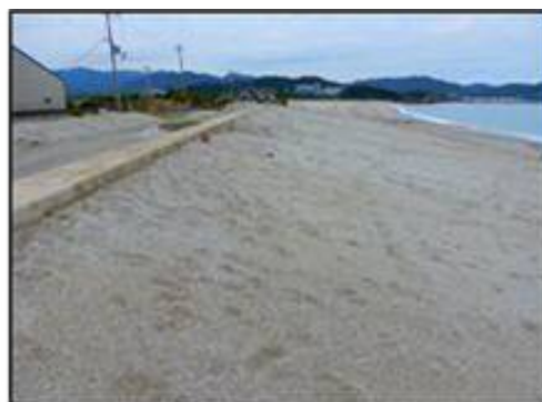
砂で前面が埋まった防潮堤
