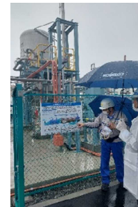
(株)神戸製鋼所 水素ガス実証設備
