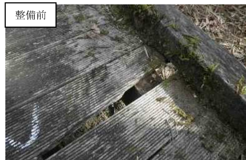
老朽化した園路
