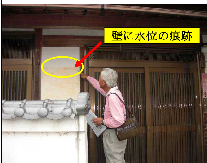
壁に水位の痕跡 到達水位 2 m以上
