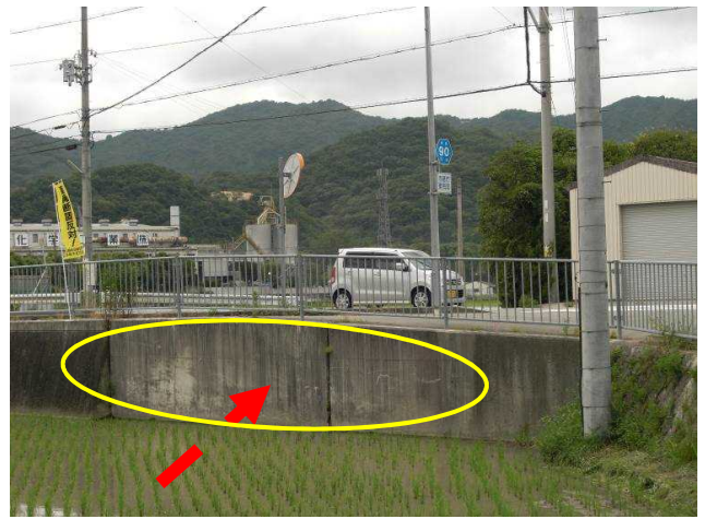
崩落改修工事箇所
