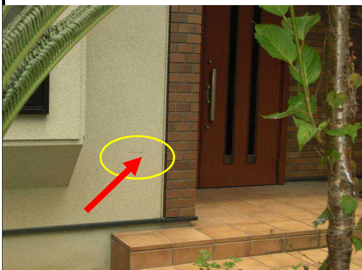
沖自治会長宅も床上浸水した
