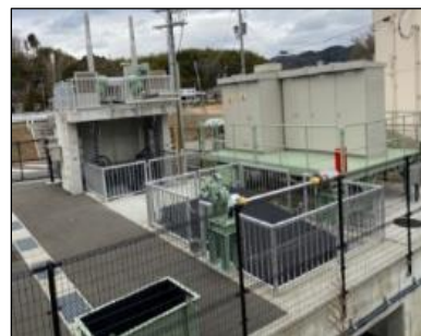
京口排水ポンプ場(丹波篠山市) 平成30年6月完成
