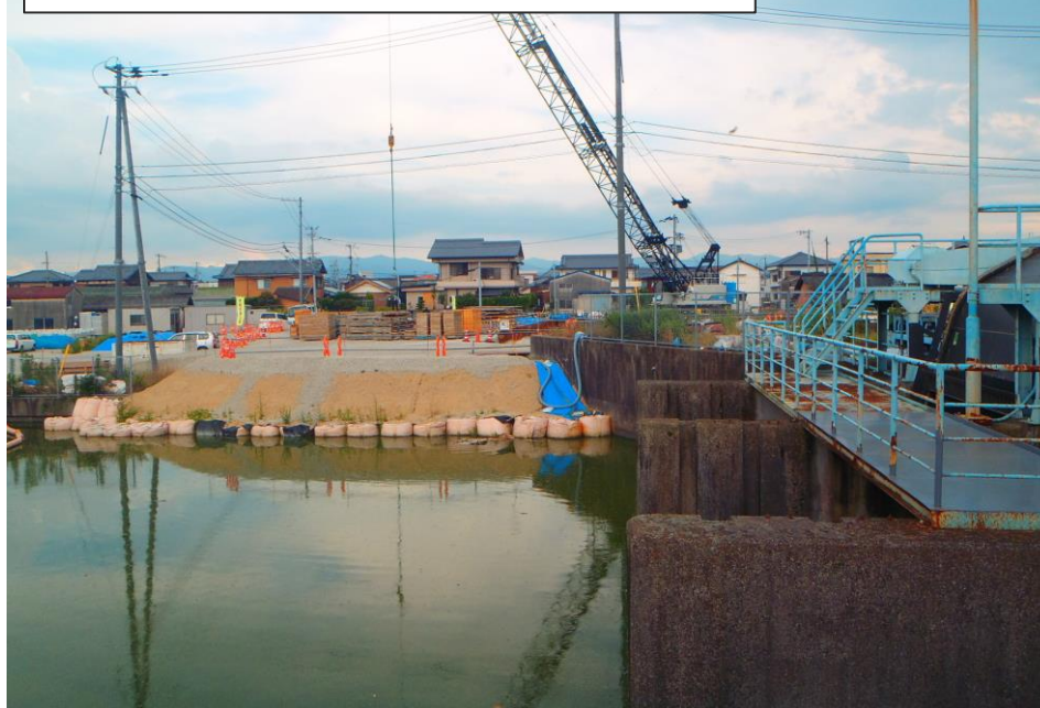
倭文川排水機場 (6.0m 3 /s、更新中)
