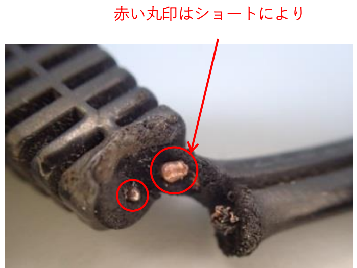
断線箇所の拡大写真
