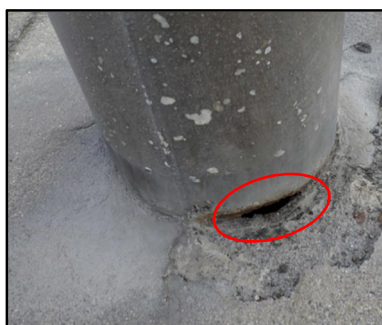
【腐食し穴のあいた信号柱】
