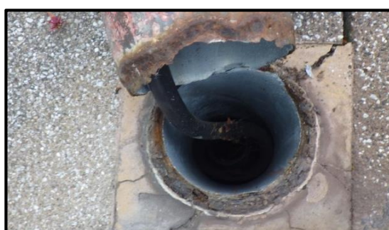
【倒壊した信号柱の地際部】
