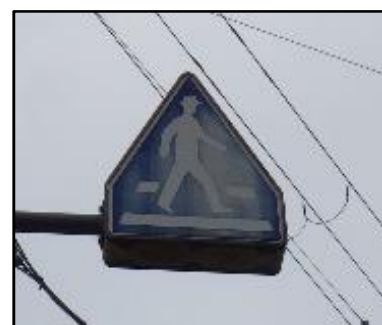
【退色した大型標識】
