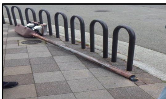
【腐食と人圧により倒壊した信号柱】
