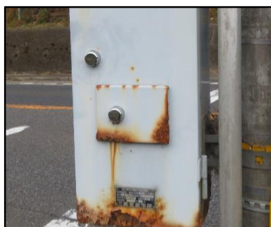
【腐食した信号制御機】
