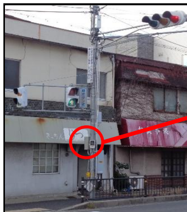
【信号機電源中継箱】
