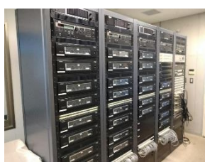
音響設備(アンプ)
