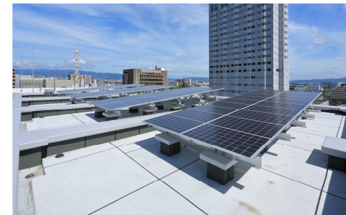
写真13 県有施設における屋上への太陽光発電設備設置の事例
