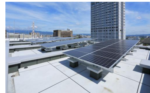
写真13 県有施設における屋上への太陽光発電設備設置の事例
