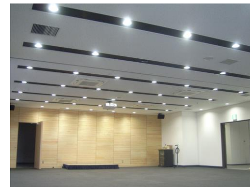
写真14 県有施設におけるLED照明器具設置の事例
