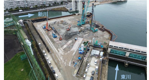
新川・東川統合排水機場（西宮市）
