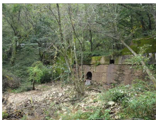
コンクリートの劣化により災害防止機能が低下（対策前）
