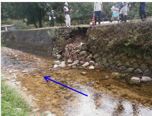
(砂) 二又江川(新温泉町諸寄) 護岸欠壊状況
