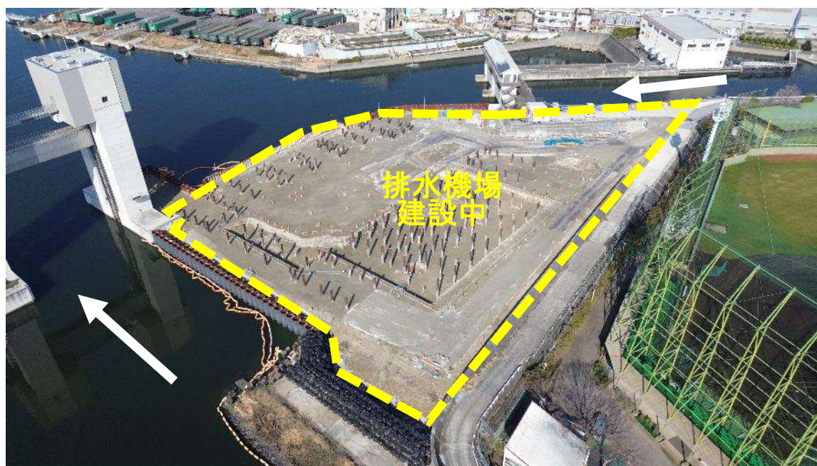
新川・東川統合排水機場(西宮市)
