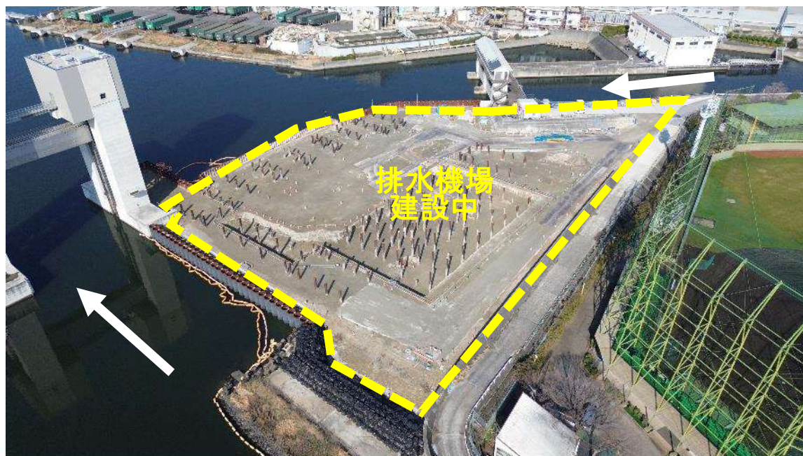
新川・東川統合排水機場(西宮市)
