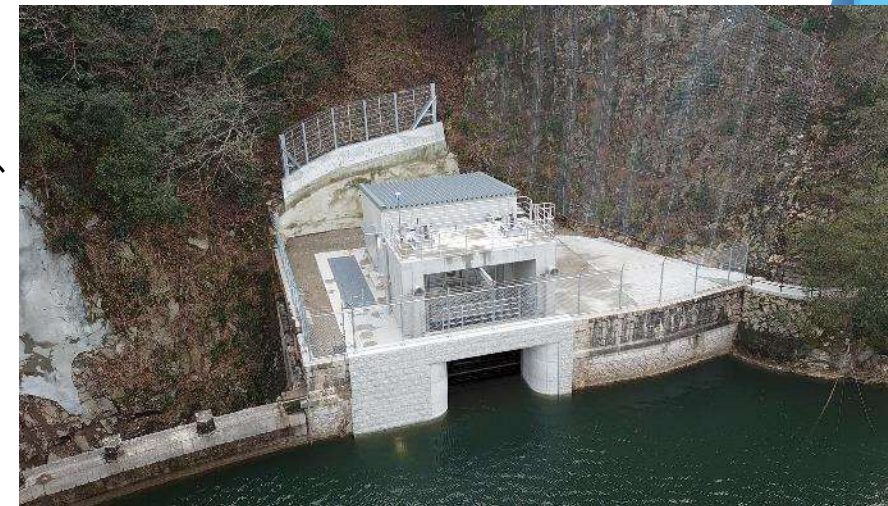
千苅ダム[治水活用放流設備](神戸市北区)
