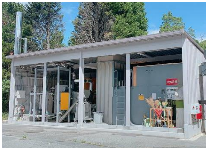
木質バイオマスボイラー（神戸市北区）
