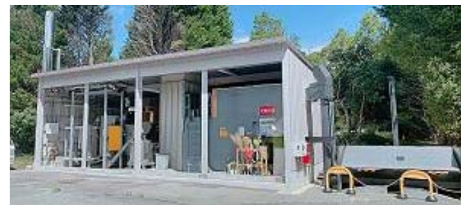
木質バイオマスボイラー
