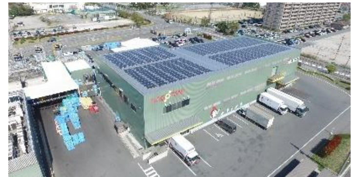
事業所に設置された太陽光発電設備
