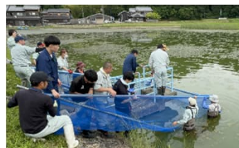
流出入口や洪水吐などに侵入防止フェンス・ネットを設置
