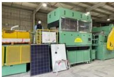
太陽光パネルのリサイクル施設
