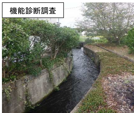
ひび割れや摩耗による水路の劣化
