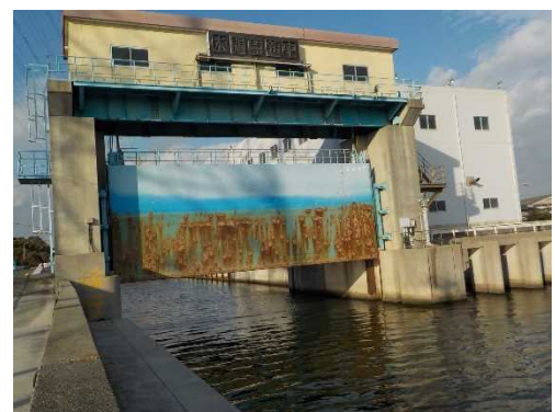
妻鹿漁港 排水機場
