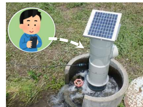
給排水の自動化と遠隔操作（たつの市）
