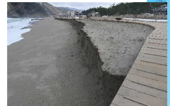
浜坂漁港 海岸の浸食状況
