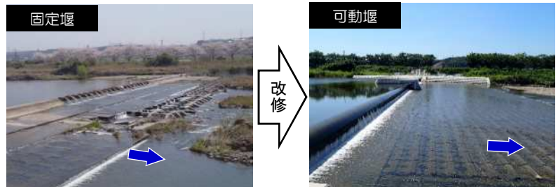
洪水を安全に流下させる可動堰へ改修（三木市和田井堰）
