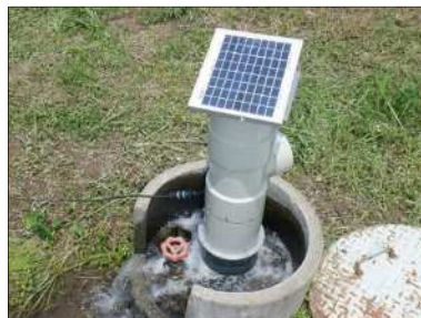
水管理労力を軽減する遠隔操作型自動給水栓（たつの市金剛山地区）
