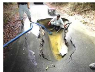
幹線パイプラインの破損 (断水・通行に支障)
