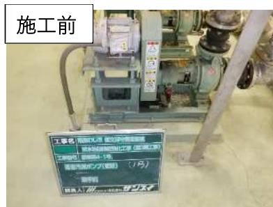
経年劣化により汚泥ポンプが作動不良
