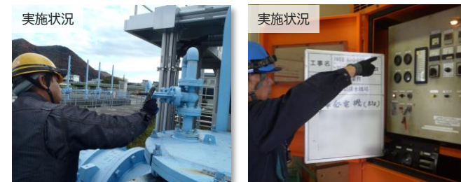
□ 排水機場の定期点検
