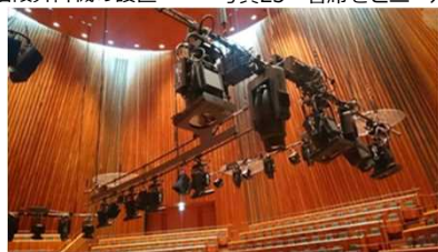
写真24 LED照明器具の導入
